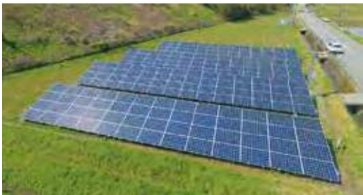
農作業が不能になった農地の有効活用法として導入が進む産業用太陽光発電事業。もちろん、一部を農業用に残す「営農型」も可能だ。
