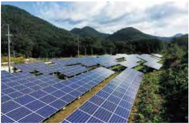
産業用太陽光発電システムとは、10kW以上の設備を指す。発電した電力のすべてを電力会社に一定価格で買い取ることを義務づけた「全量固定買取制度」の実現によって、道が大きく開けた。
